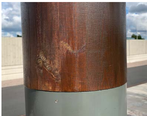
Figur 173. Belysningsstolparna är av trä med en del lackerad i RAL 7010. Bildkälla: Sydväst
