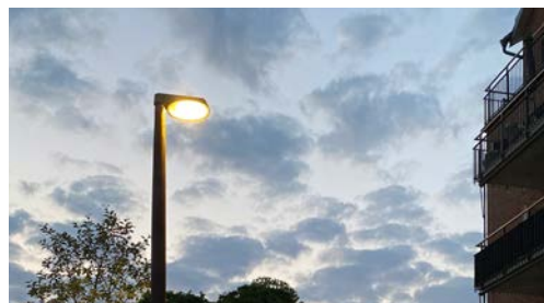
Figur 84. Vägbelysningsarmatur, Fox Design - "PEAK 380" på trästolpe. Bildkälla: Sydväst
