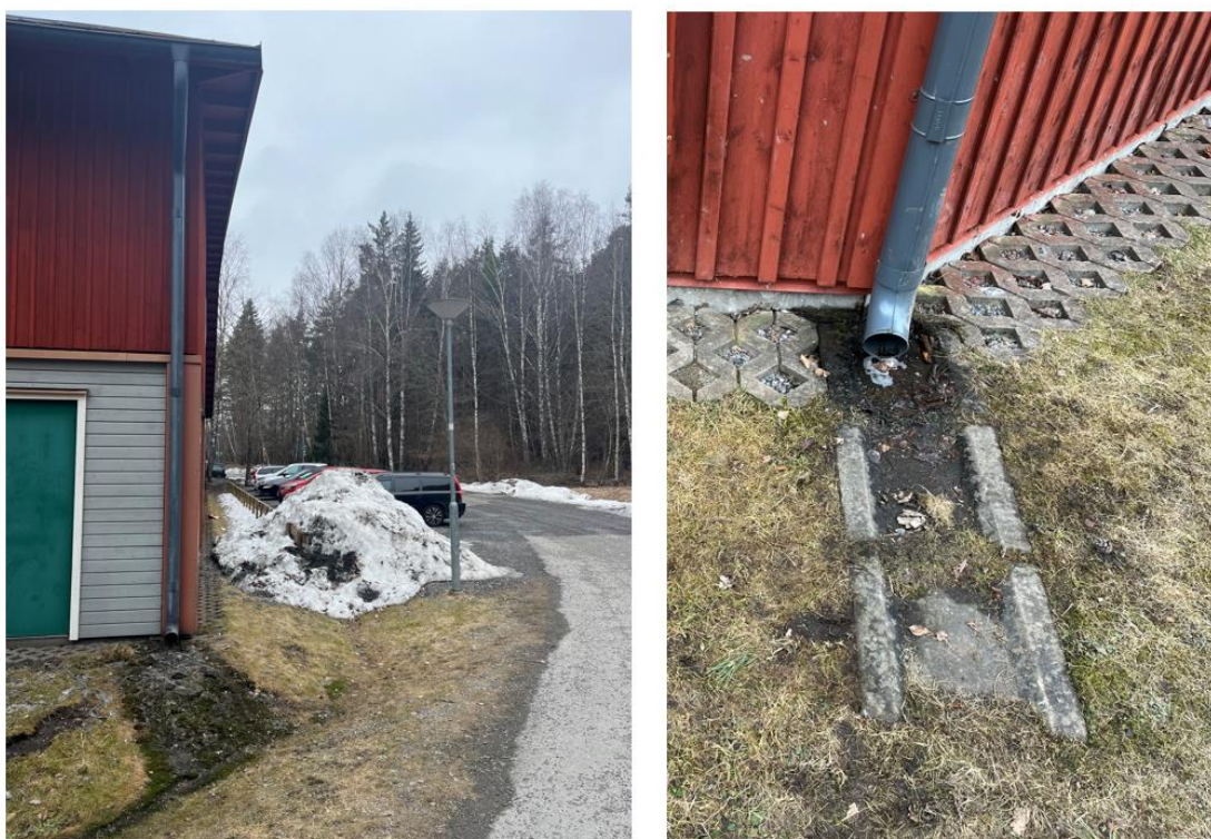
Figur 2-5 Stuprörsutkastare från gymnastiksalens norra fasad (t.v.) och skolbyggnaden längst i öster (t.h.). Foto: Brita Stenvall
