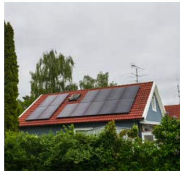
Solceller på villatak
